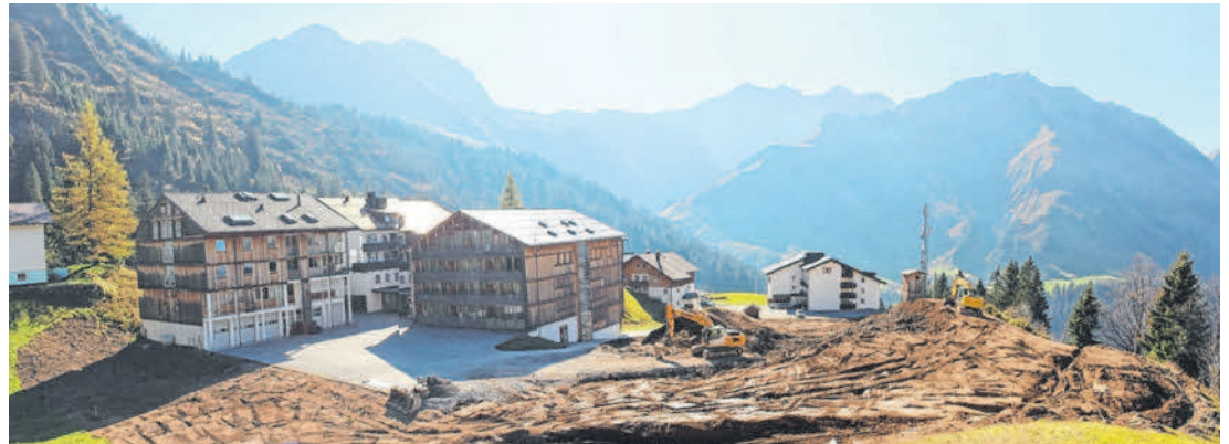
Eine im Eiltempo durchgezogene Baustellenvorbereitung lässt die Größe des geplanten Mega-Projekts in Schröcken-Nesslegg erahnen.
